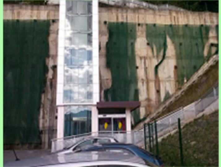
En octubre, hemos comprobado que dicha malla sigue estando en mal estado en su zona más expuesta.
